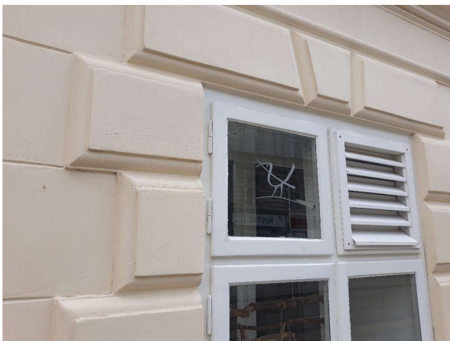
Obr.4: Detail fasáda po sanácii - okno
