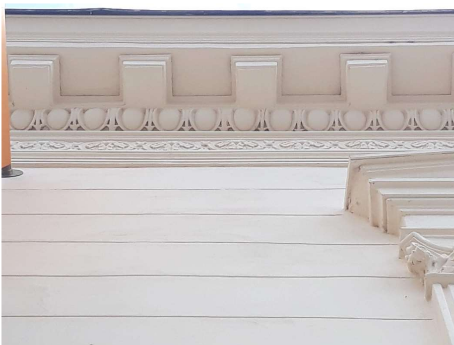
Obr.6: Detail fasáda po sanácii – podstrešná rímsa
