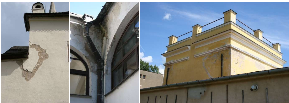
Obr. 1, 2, 3. Poruchy fasád v dôsledku technických porúch strešného plášťa. Zdroj: autorka
